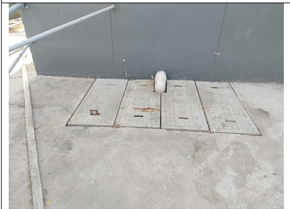
红牛屠宰间污水收集池
