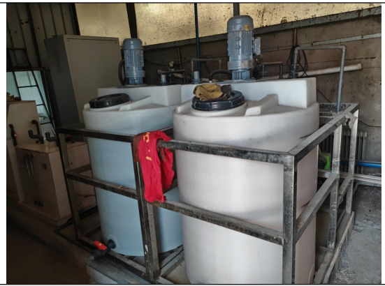
污水处理站药剂罐
