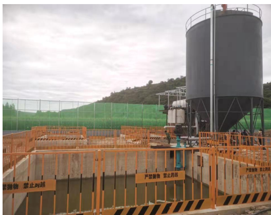
沉淀池及沉淀塔
