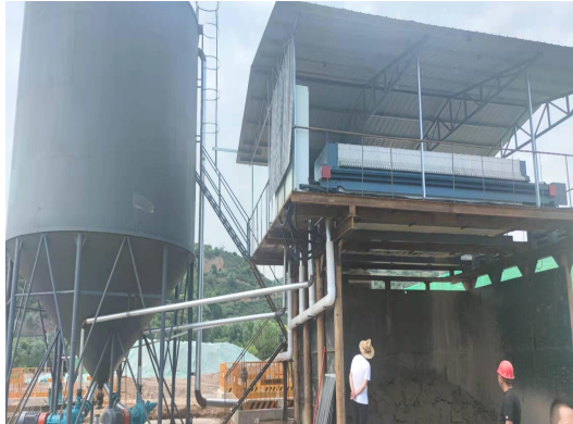
压泥机及沉淀罐
