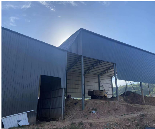
封闭式受料口
