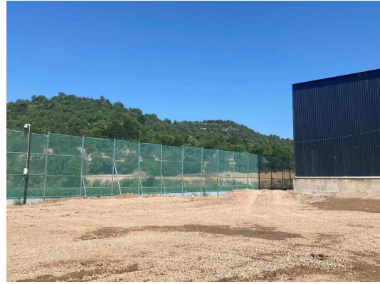
厂区抑尘网围挡
