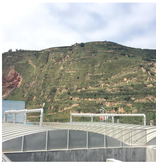
各池体上方废气收集管道
