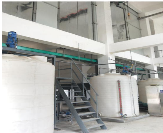
污泥脱水机房设备
