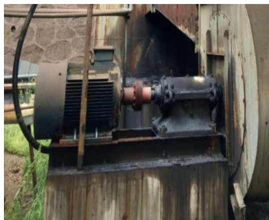
水泵减震基座
