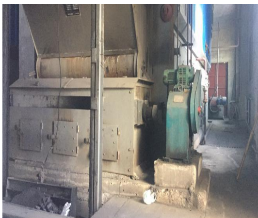
锅炉减震基座
