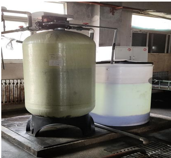
锅炉软化水设备
