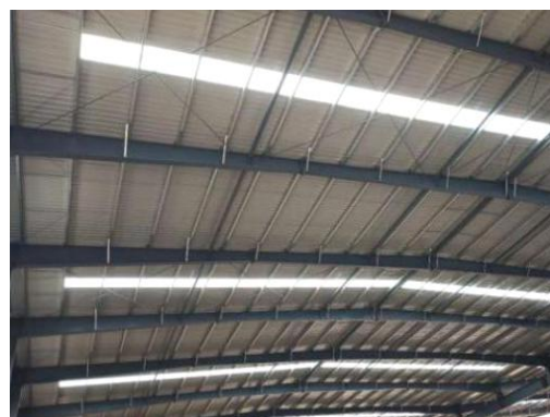
洒水喷淋设施
