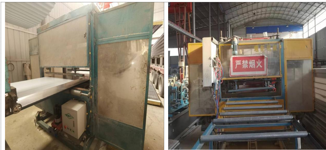
切割工序半封闭集尘装置
